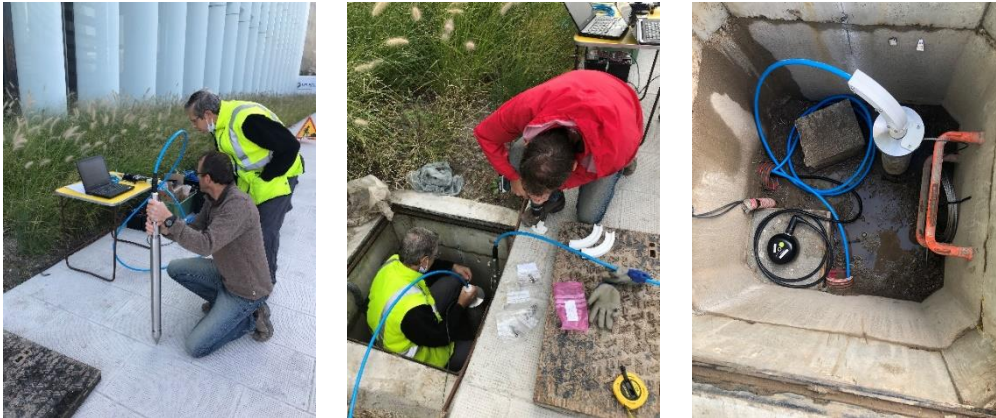
Installation des capteurs à l'extérieur. A gauche : contrôle de l'orientation du radian mesurée par la minimus avant sa mise en place ; au centre : installation du radian dans son puit ; à droite : tête de forage équipée : radian à -10 m et accéléromètre fortis orienté au gyrocompas en surface.
